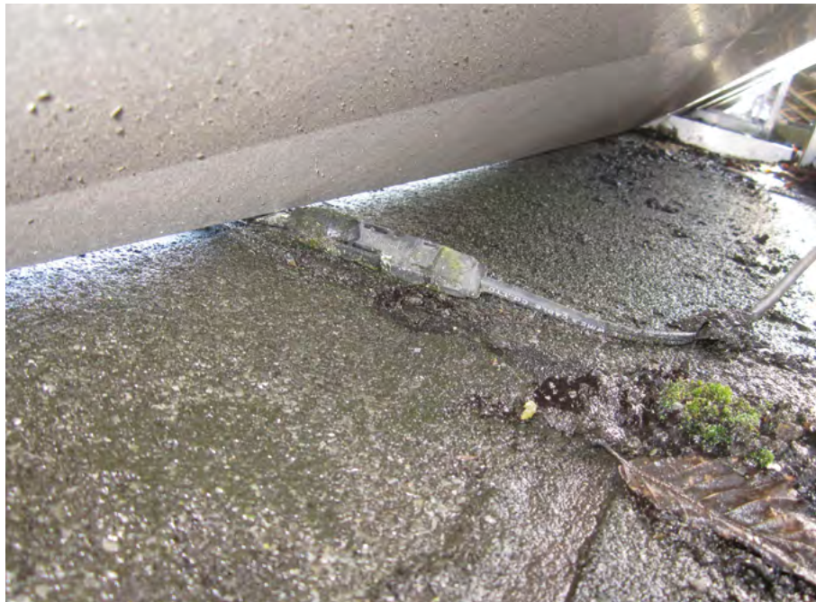
Bild 3 / Ungeschützt verlegter Steckverbinder auf der brennbaren Dachhaut
