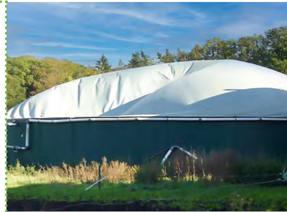
Bild 10 / Instabile Wetterschutzfolie durch zu geringen Stützluftdruck
