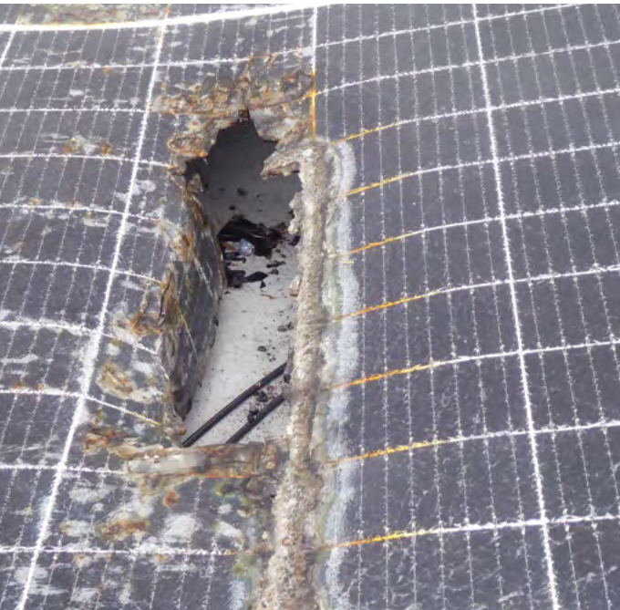
Bild 2 / Lichtbogenschaden am Modul
