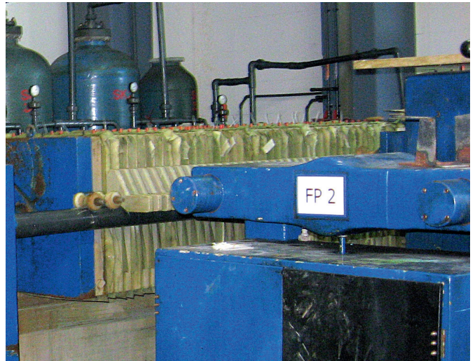
Abwasserbehandlung mit Kammerfilterpresse zur Behandlung des Abwassers in einem abgetrennten Bereich.
