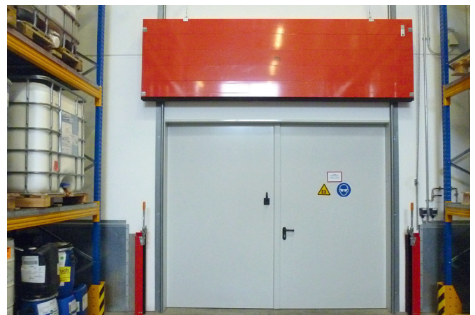
Löschwasserschott in einem Gefahrstofflager.
