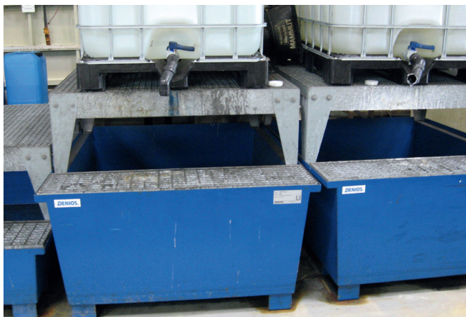
Lagerung und Abfüllung von Zusatzstoffen über Auffangwannen.
