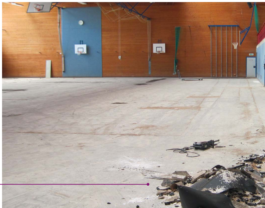
Schulturnhalle nach dem Hochwasser 2013.
