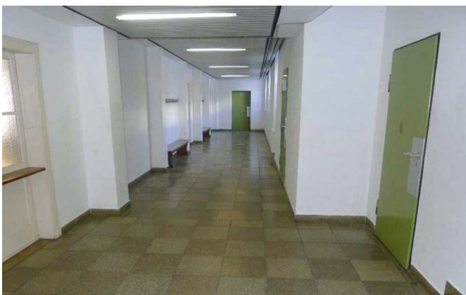
Aufschlagende Türen dürfen den Flucht- und Rettungsweg nicht behindern und müssen gegebenenfalls zurückgesetzt werden.
