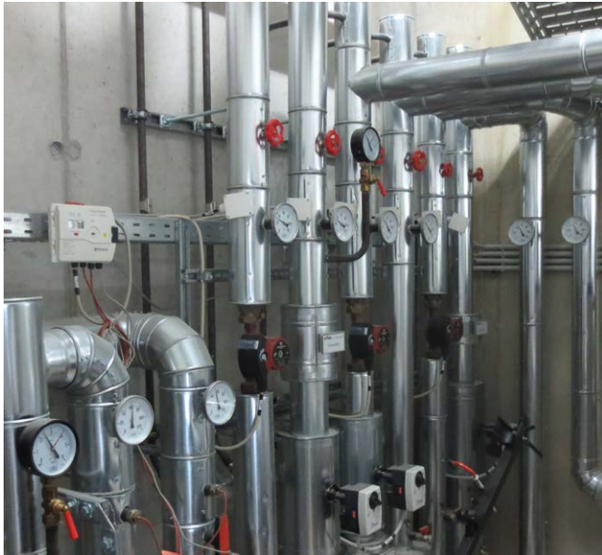
Die Heizzentrale gehört unter anderem zu den sensiblen Bereichen und birgt ein erhöhtes Risiko. Sie sollte daher unbedingt abgesichert werden.
