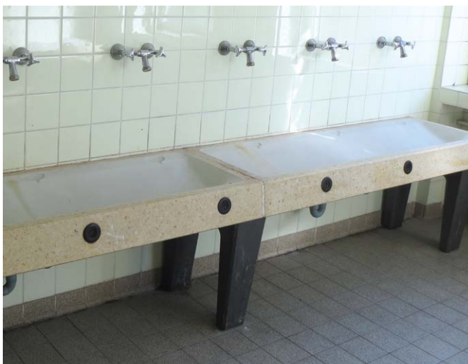
Wenig genutzte Leitungswasserentnahmestellen sollten zurückgebaut werden.
