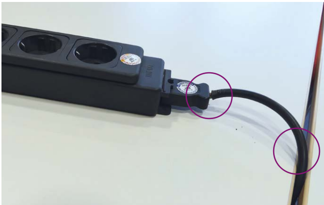
Das Prüfsiegel trägt – das Anschlusskabel des Mehrfachsteckers ist beschädigt und zudem zwischen zwei Tischen eingeklemmt.
