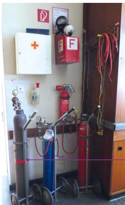
Feuerlöscher sowie Utensilien für die erste Hilfe griffbereit im Übungsraum – leider wird der Zugang hier durch Arbeitsmaterial behindert.
