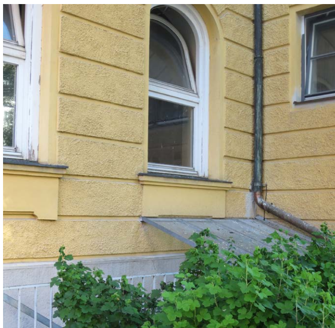
Achtung Einstiegsgefahr! – Gekippte Fenster und Aufstiegshilfen durch Dach und Geländer!
