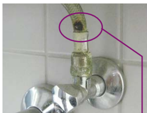
Der Flexschlauch ist verrostet – ein Wasserschaden droht. Überall, wo Leckagen möglich sind, ist ein Wasserwächter eine gute Investition.
