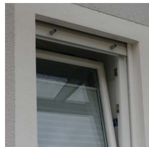
So nicht – ein gekipptes Fenster ist ein offenes Fenster und animiert zum Einbruch. Schließen Sie daher alle Fenster beim Verlassen von Haus oder Wohnung.
