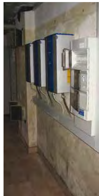
Das Hochwasser überflutete auch die Wechselrichter im Keller.
