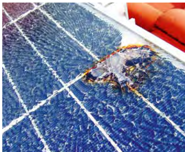
Eine Zellverschattung führte zum Hotspot. Regen ließ die Solarglassscheibe und die überhitzte Stelle regelrecht „explodieren“.
