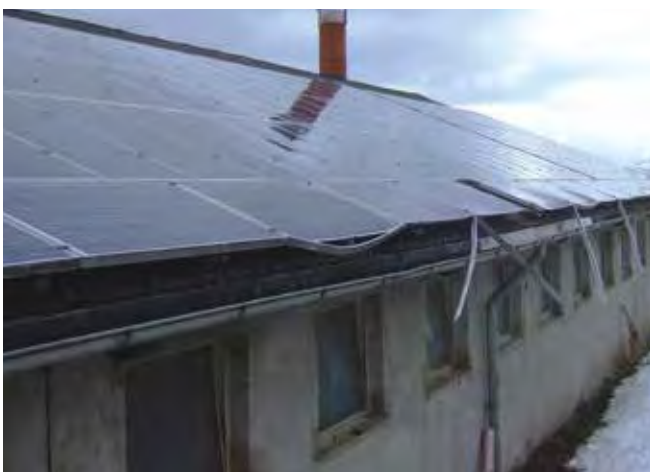
Auf diesem relativ flachen Dach setzte sich abrutschender Schnee an der Unterkante fest und vereiste. Tauwetter führte zum rapiden Abrutschen und verbog die Unterkante der Module.
