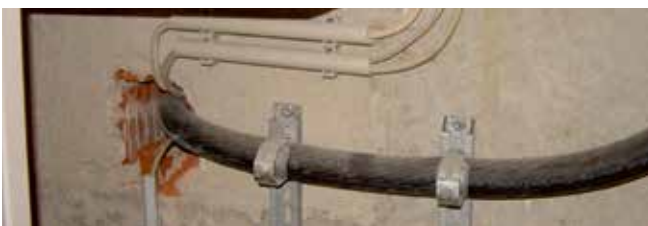
Bild: Eine nicht geschlossene Durchführung leitet im Brandfall Feuer und Rauch weiter.
