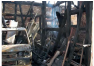
Brandursache war hier das unzulässig abgestellte Kfz im Scheunenanbau.
