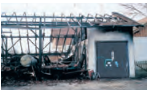
Der in der Garage abgestellte Traktor blieb bei dem Scheunenbrand unbeschädigt.
