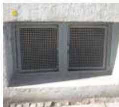
Bild: Ein Mäusegitter ist i.d.R. kein Einbruchschutz.
