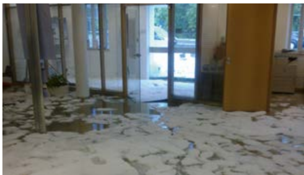
Starkregen mit Hagel drückte in diese Geschäftsräume.
