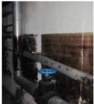
Ölschaden nach dem Hochwasser
