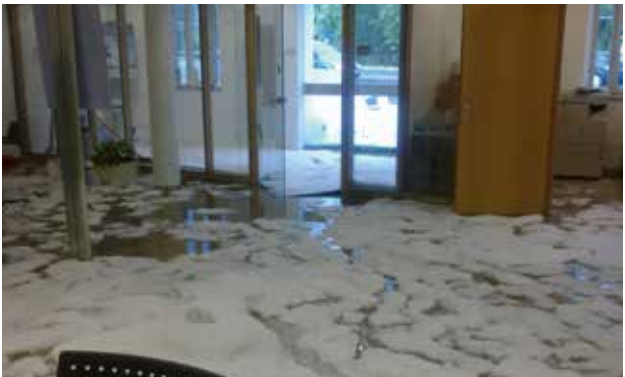
Starkregen mit Hagel drückte in diese Geschäftsräume.
