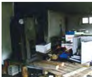
Funkenflug durch Schweißarbeiten am Treppengeländer entzündete Baumaterial und verrußte den ganzen Rohbau.
