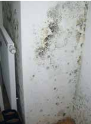
Bild: Schimmel als Folge von ungünstigen Umständen, wie hier eine längere Abwesenheit bei einem nicht entdeckten Leitungswasserschaden (Frost im Dachgeschoss) und damit ausbleibenden schadenmindernden Maßnahmen.
