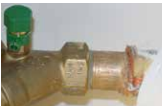
Bild: Korrosion einer Leitung. Ursache: Eintrag von Fremdkörpern in die Leitung.
