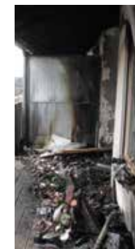
Schadenbild: Eine (verirrte?) Silvesterrakete setzte über den Balkon hinweg auch die Wohnung in Brand.
